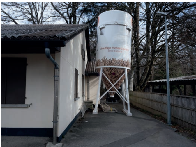
Silo du chauffage à pellets de la Cantine.
